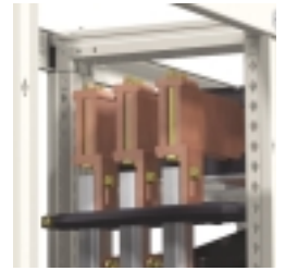
Conexão barramento horizontal
