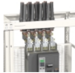
Conexão a montante por cabos
